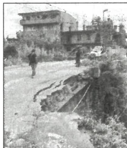
Strada franata a Mosorrofa
