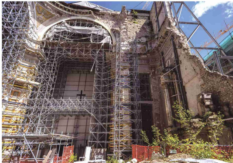
L'Aquila, ricostruzione di un monumento distrutto dal terremoto del 6 aprile del 2009 Foto Stefano Montesi - Corbis/ Getty Images
