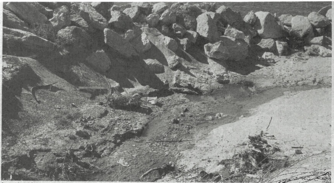
Scempio La fogna a mare in prossimità della rotonda delle ex Omeca nell'area del Parco Lineare Sud
