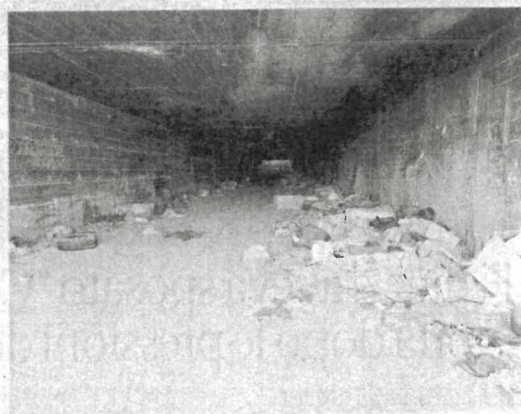
Degrado senza fine Il tunnel che conduce alla spiaggia “La Sorgente”
