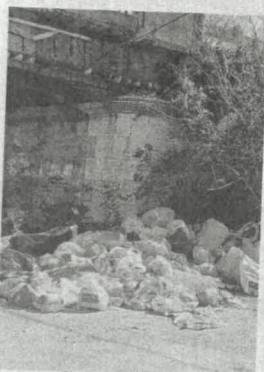
Fiumarella Uno dei siti in cui spesso vengono abbandonati i rifiuti
