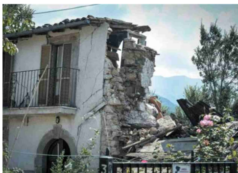
Un edificio danneggiato dal sisma nei dintorni di Amatrice
