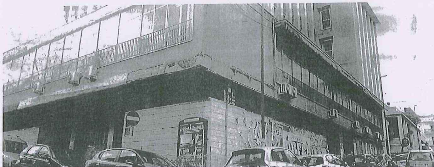
Palazzo Sanità La sede di via Willermin da sei anni recintata per motivi di sicurezza aspetta interventi di ristrutturazione
