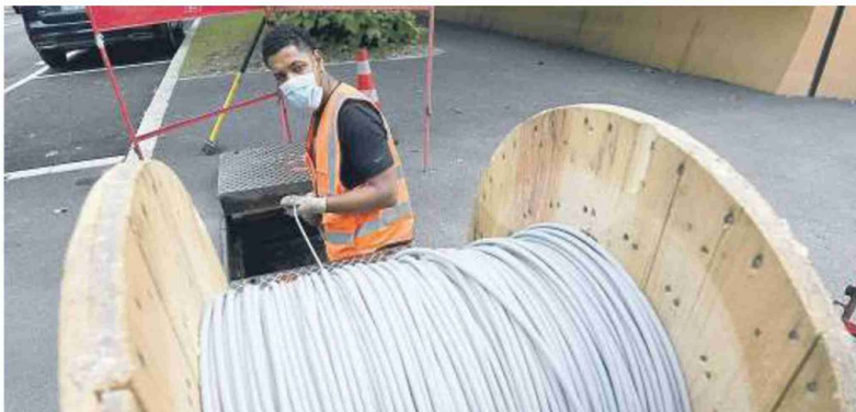
Un tecnico al lavoro per il cablaggio dei cavi della fibra ottica (foto Ansa/Daniel Dal Zenaro)
