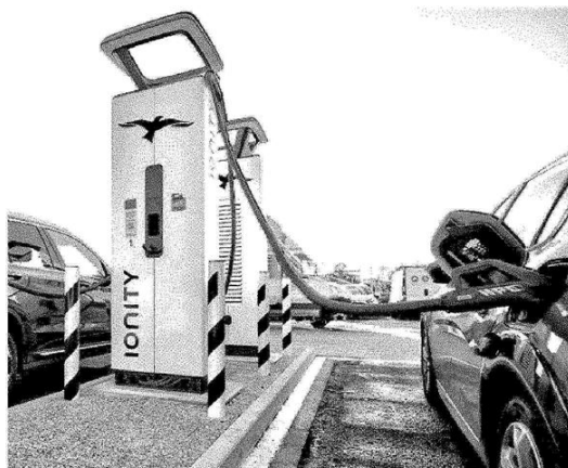
Ricarica. Stazioni per le auto elettriche lungo un'autostrada del gruppo Astm
