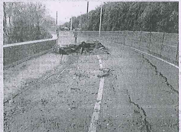
Il cedimento sulla strada di accesso alla frazione, è la seconda volta che accade in due anni
