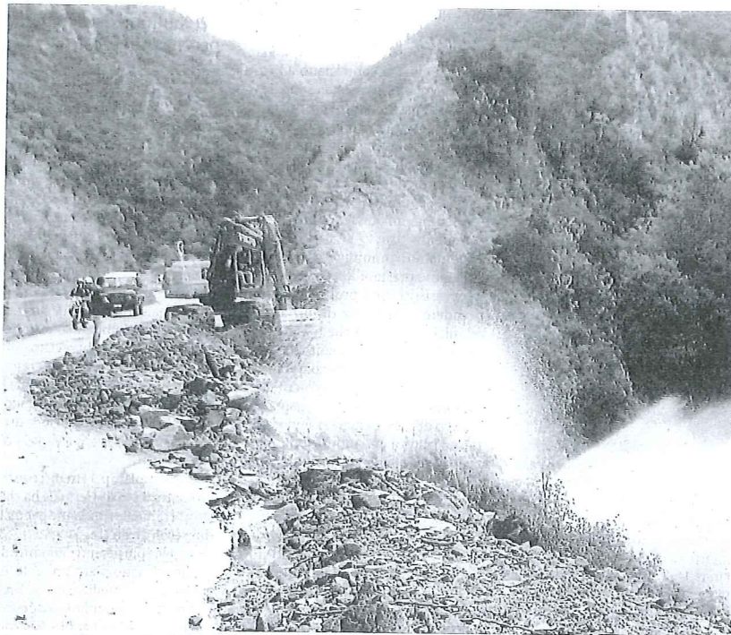
Gestione dell'acqua Un dei tanti guasti che si è venuto a creare su una delle condotte principali
