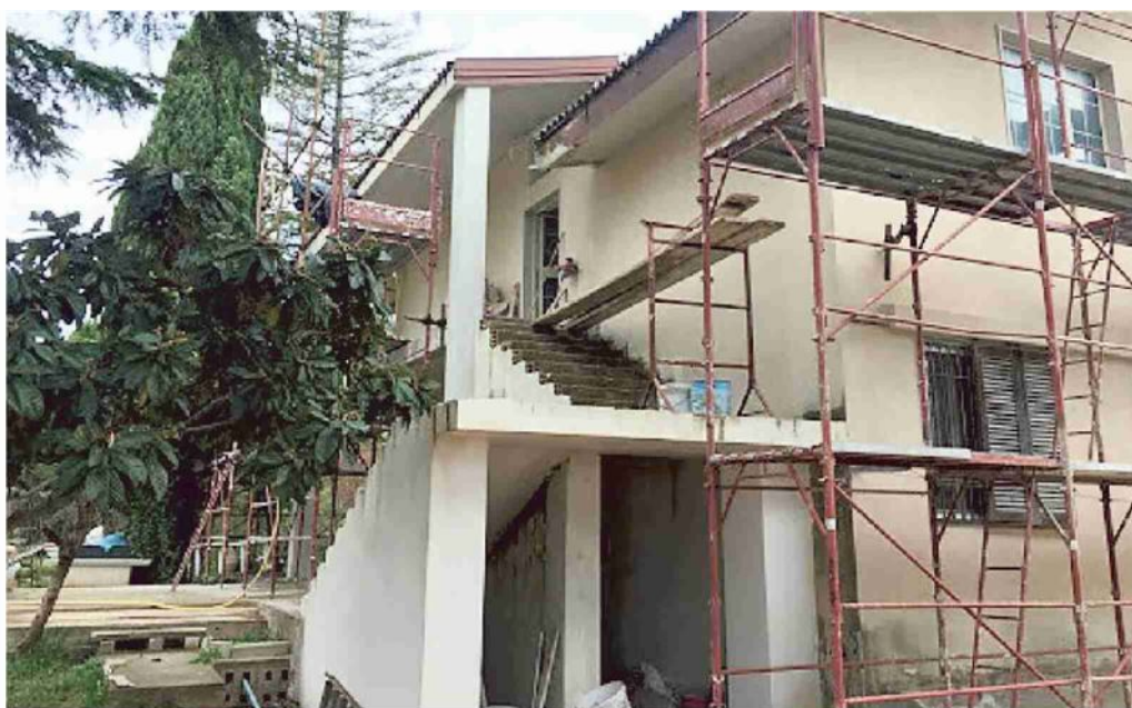
Il cappotto termico permette una maggiore efficienza energetica dell'edificio
