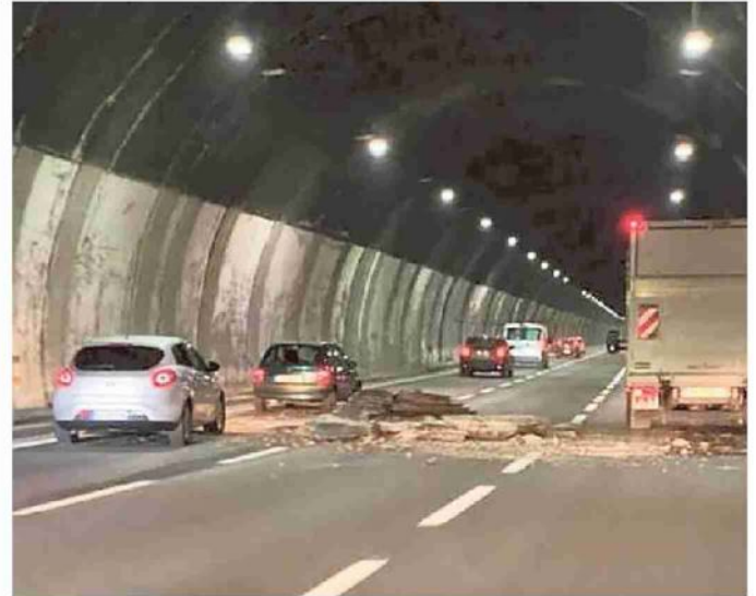
Il crollo nella galleria Bertè, sulla A26, del 30 dicembre 2019
