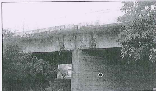
Le condizioni precarie del Ponte di Sant'Anna, tra parti ammalorate e rifiuti abbandonati
