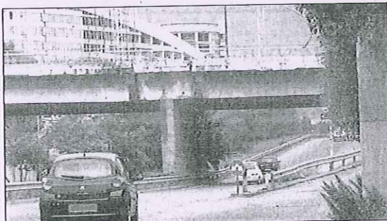
Due foto del fatiscente degrado del Ponte di Sant'Anna
