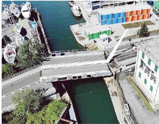
Il ponte mobile crollato alla Spezia
