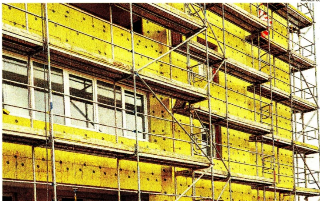
Lavoro trainante. Il cappotto termico è spesso indispensabile per l'ecobonus 110% ma il costo dei ponteggi è raddoppiato
