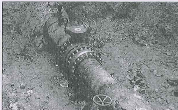
Una condotta idrica
