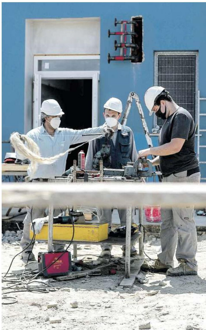
SICUREZZA Operai al lavoro presso un istituto scolastico muniti dei dispositivi di sicurezza durante il periodo di lockdown (foto ANSA)
