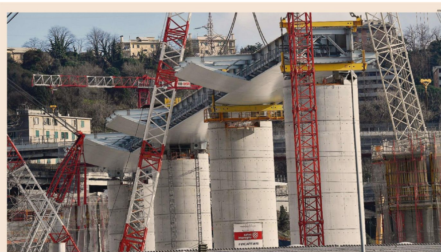
Opera simbolo. Anche l'ultimo gigante di calcestruzzo è stato terminato. Nel cantiere del nuovo ponte di Genova si sono conclusi i lavori sulla pila 12, uno dei 18 piloni che sorreggeranno l'impalcato di oltre mille metri. L'opera rappresenta un'importante tappa raggiunta nel percorso di costruzione del viadotto
