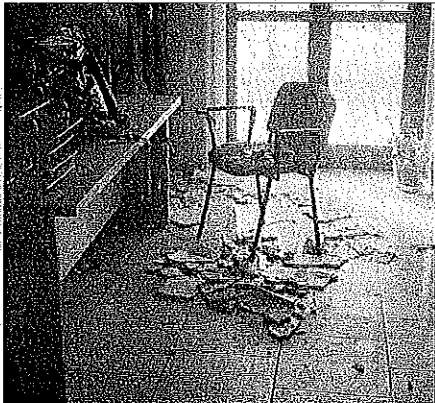
Pezzi del soffitto sbriciolato sul pavimento di un piano
