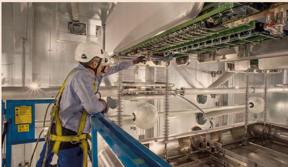
Italia-Montenegro. Tecnici al lavoro all'interno di Cepagatti, la stazione italiana dell'elettrodotto in provincia di Pescara
