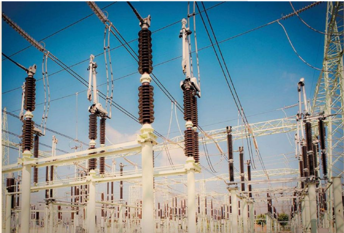
Produzione energetica. La centrale termoelettrica A2A di Cassano D'Adda
