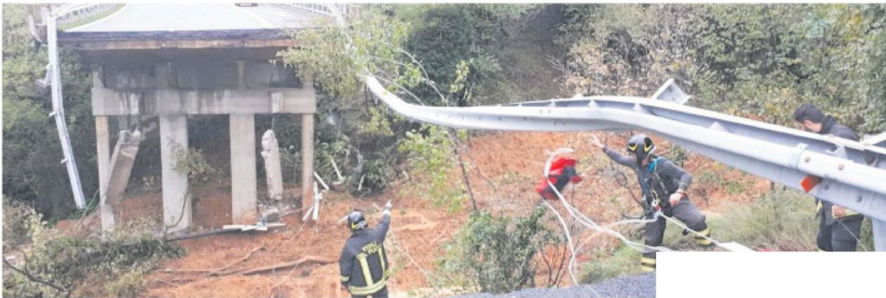
CROLLATO Venti metri del Viadotto Madonna del Monte lungo l'autostrada Torino-Savonera sono crollati dopo che una massa di fango è venuta giù dal monte sovrastante a causa della pioggia che si è abbattuta incessantemente sulla regione
