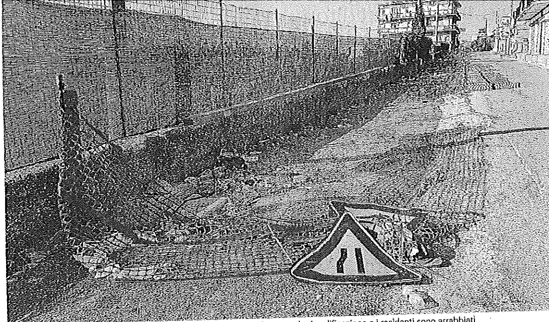
Cantiere fermo da anni La via Anita Garibaldi a Gallico aspetta da tempo la riqualificazione e i residenti sono arrabbiati
