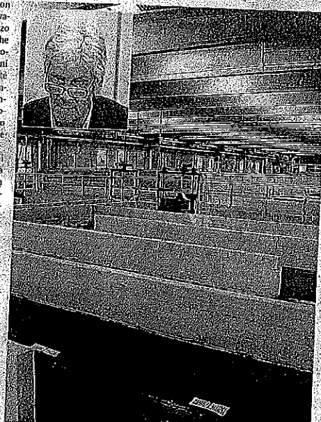
Sottile in Via L'Interno del depuratore di Ravennese, nel riquadro: Rolle
