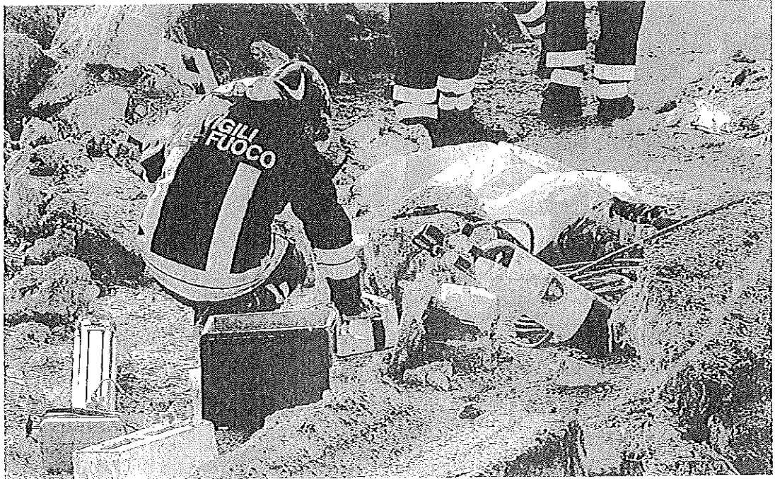
Morire di lavoro Le tragedie nei cantieri restano purtroppo ancora una emergenza in tutta la regione
