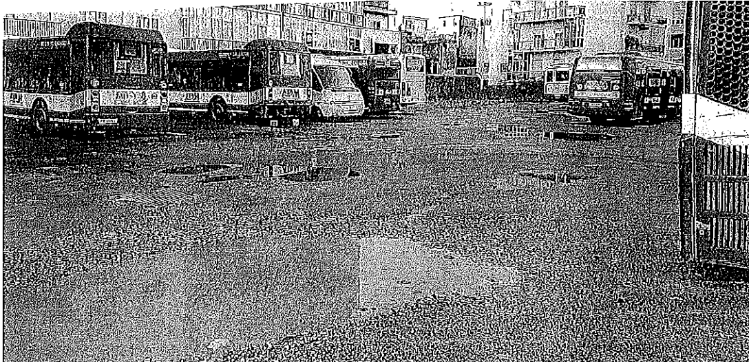
La manutenzione che non c'è. Le condizioni del piazzale del deposito dei bus Atam di via Foro Boario
