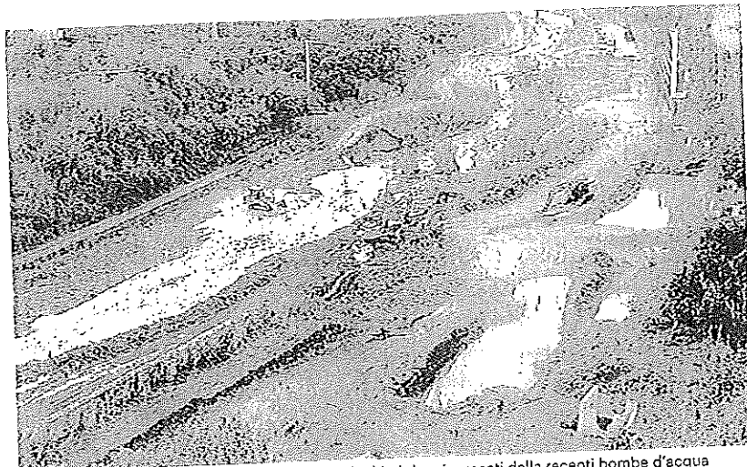
Cantiere devastato Una foto emblematica degli ultimi danni arrecati dalle recenti bombe d'acqua
