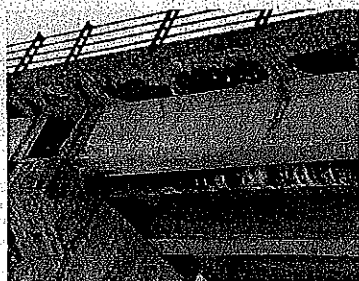
Le condizioni precarie del ponte sul torrente Allaro
