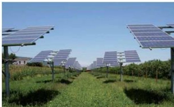
impianto ad inseguimento
