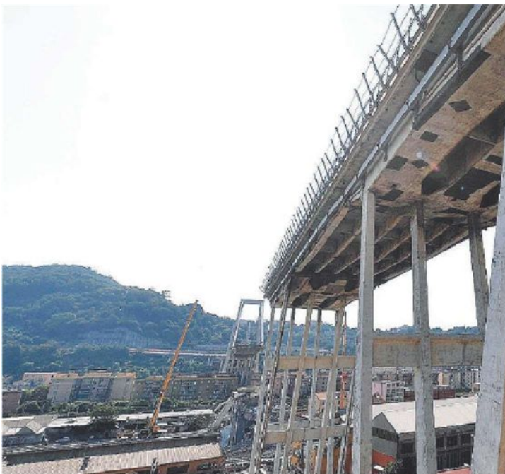
MORANDI Lo stato della parte ovest del ponte
