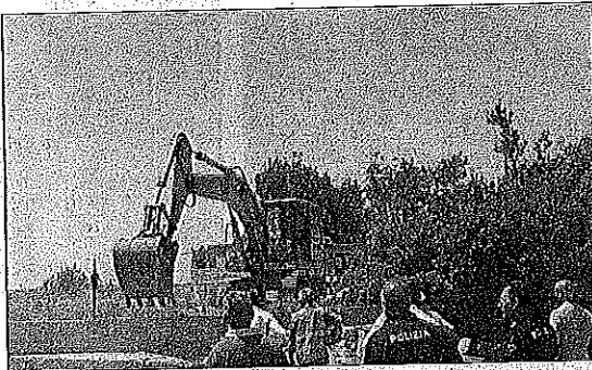
L'inizio dei lavori per il lungomare e lo sgombero del Camping Punta Stilo
