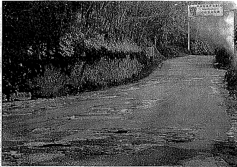
Il caso. Le strade dell'area metropolitana versano in uno stato pietoso e la manutenzione va avanti al lumicino
