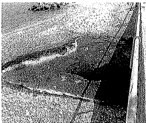
Litorale di Pellaro. Il fetido ristagno di liquami a cielo aperto
