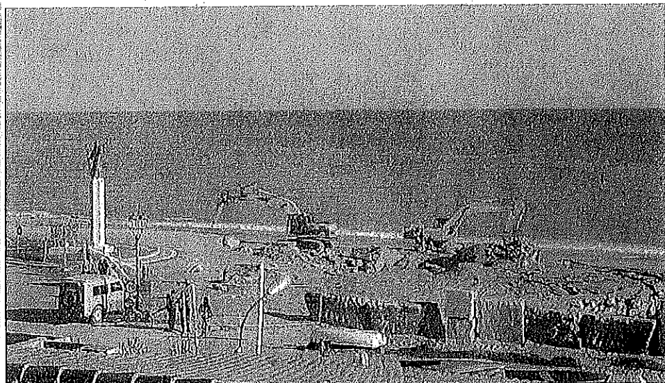
Lavori in corso. Il cantiere aperto da pochi giorni per la ricostruzione del lungomare sidernese
