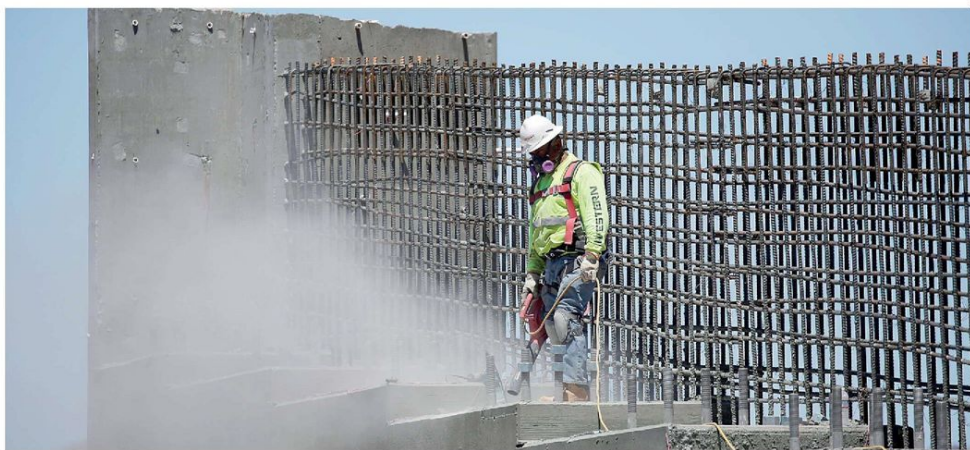
Grandi opere. Un operaio al lavoro sulla Interstatale 11 in Nevada, nei pressi di Boulder City
