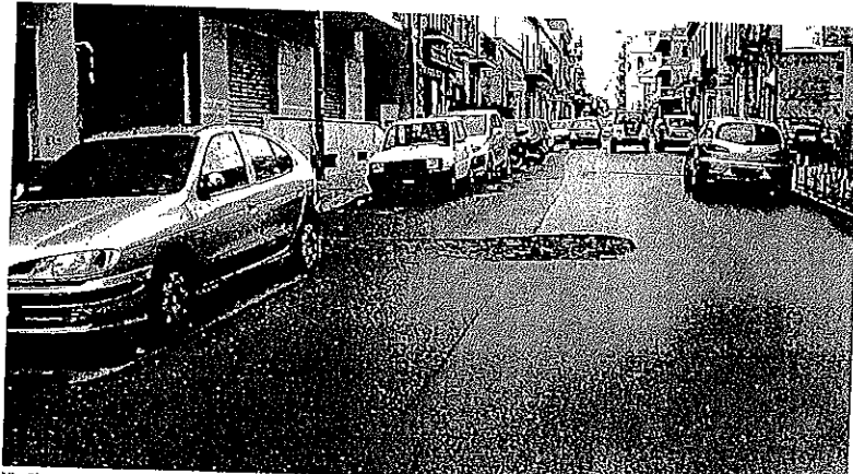
Via Sbarra. Una delle più trafficate arterie cittadine dove il Comune ha deciso di intervenire per rifare il manto stradale disastrosato
