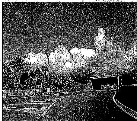
Incompiuta. Lo svincolo Malderiti funziona a metà
