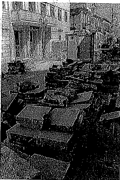
Basole accatastate. Le pietre laviche estratte dalla carreggiata e pronte per essere riposizionate sul Corso Garibaldi
