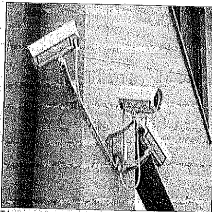
Telecamere della video sorveglianza
